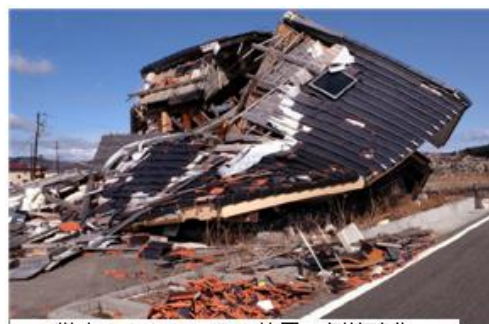
撤去もされないまま放置の倒壊建物
