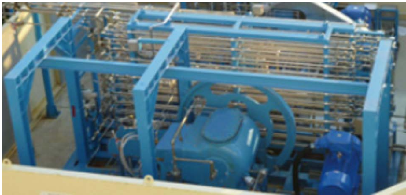
神戸製鋼所内 高圧水素テスト設備
